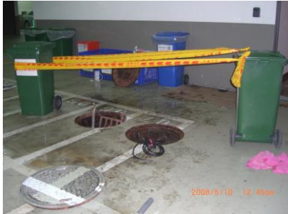
罹災現場之污水池。
